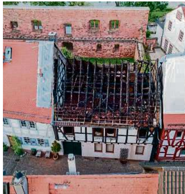
Beim Blick durch den verkohlten Dachstuhl ist vom Inneren des Hauses nichts mehr zu erkennen.
